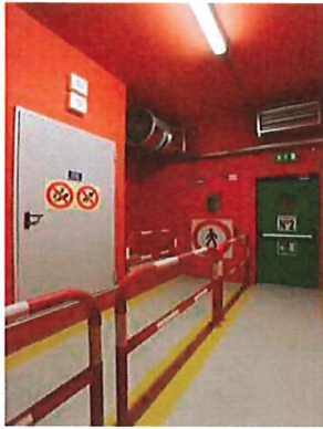
Interno filtro del By-pass.
